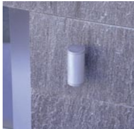
Fassadenbeleuchtung als gestalterisches Element in der Fassade, von oben nach unten , ideal gelöst.
