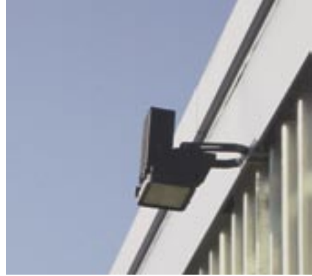
Fassadenbeleuchtung als gestalterisches Element in der Fassade, von oben nach unten , ideal gelöst.
