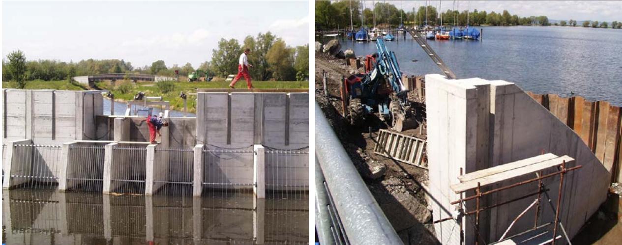
Abbildung 3: Bau des Pumpwerks für den Verbindungskanal zwischen dem Fischteich und der Dornbirnerach (links) und die Stemmwand zur Abtrennung von Fischteich und dem Binnenbecken (rechts); (Quelle: Institut für Umwelt und Lebensmittelsicherheit).
