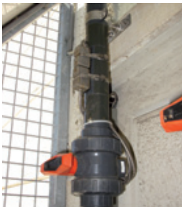
Sender und Empfänger der Ultraschallmessung an der Befüllleitung
