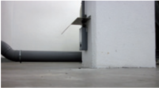
Chlorgassensor, im Hintergrund Absaugrohr für einen externen Abluftwäscher
