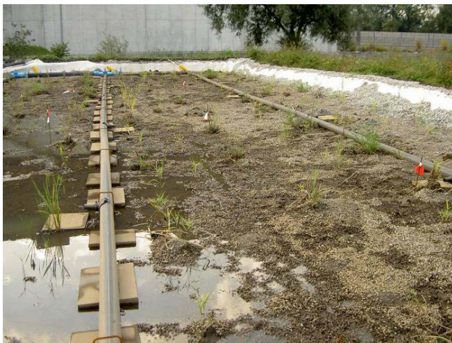
Abb. 12: Anlage nach Wassereintrag.
