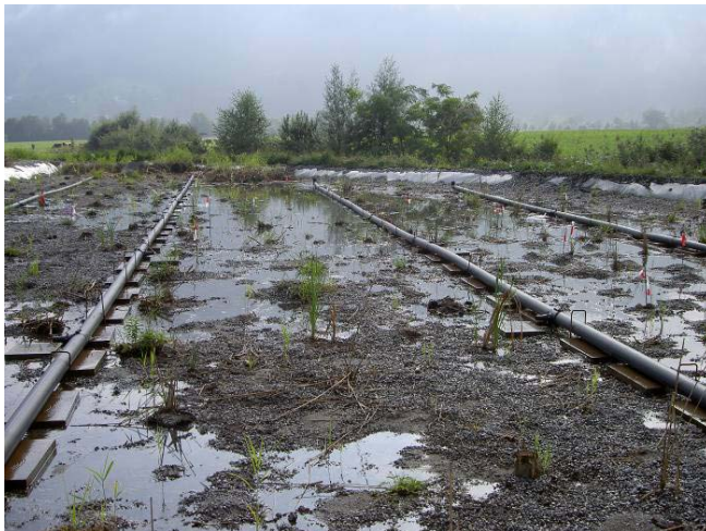
Abb. 11: Anlage nach Wassereintrag.
