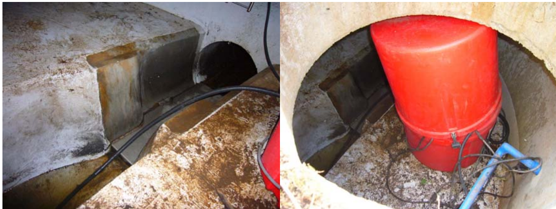
Abbildung 2: Venturigerinne und automatisches Probenahmegeräte im Messschacht
